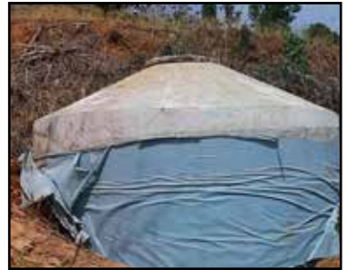
पिणालु बारी खानेपानी ट्याङ्की
